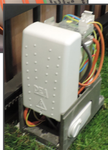
Utiliser les passes câble
